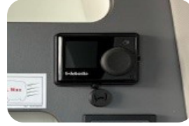
Regulador de la calefacción
