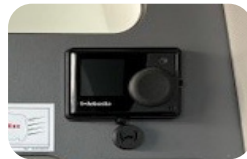
Druckregler der Heizung
